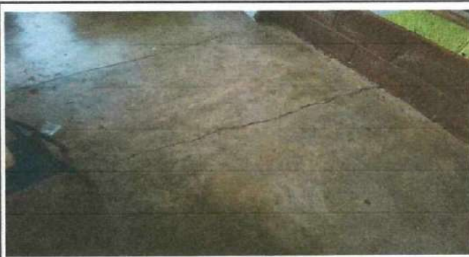
Foto 2: PISO LISO EN MAL ESTADO Y RAJADO
